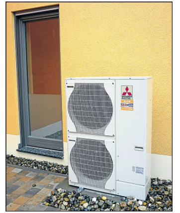
Die Wärmepumpe ist ein Beispiel für die platzsparende Nutzung von Umweltenergie.
